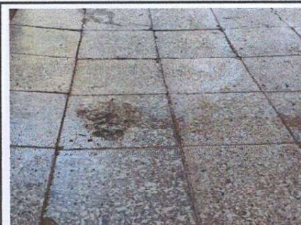
Foto 6: piso en mal estado
